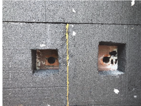
Imagen 7: Ejemplo de incorrecto aislamiento de un SATE ya instalado donde se están realizando pasos de instalaciones a posteriori por falta de previsión. Fuente: Marta Epelde.
