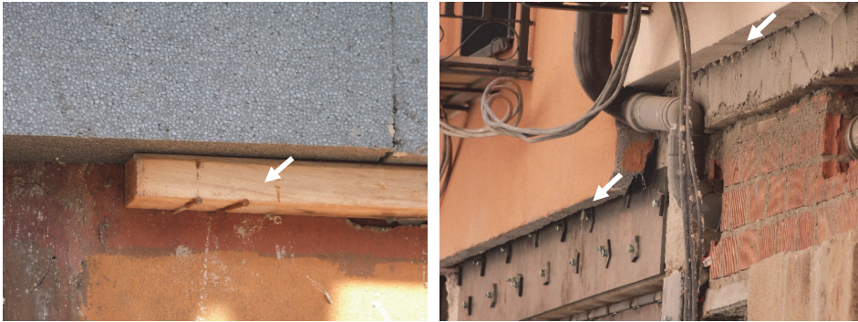
Imagen 44: Perfil de arranque inapropiado. Fuente: Marta Epelde. Imagen 45: Ausencia de perfil de arranque. Fuente: Marta Epelde.
