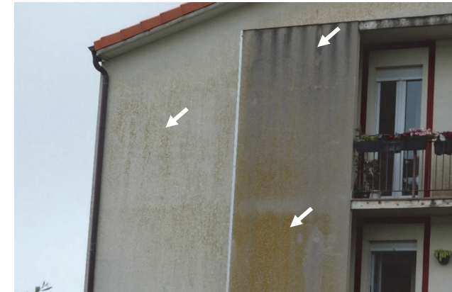
Imagen 43: Ensuciamiento y contaminación microbiológica en fachada norte del SATE. Fuente: Marta Epelde.
