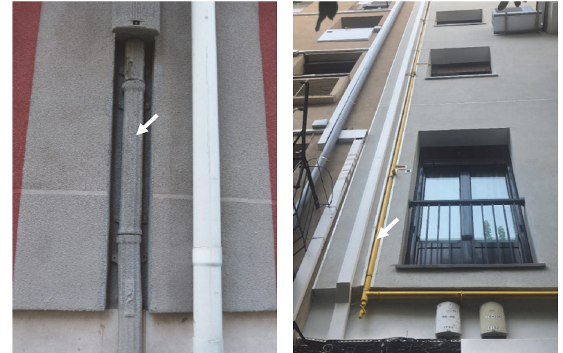
Imagen 47: Aislamiento interrumpido por canaleta metálica. Fuente: Marta Epelde.
