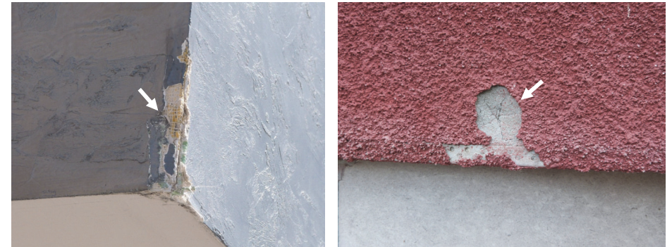
Imagen 36: Impacto en esquina saliente en voladizo de un SATE. Fuente: Marta Epelde.
