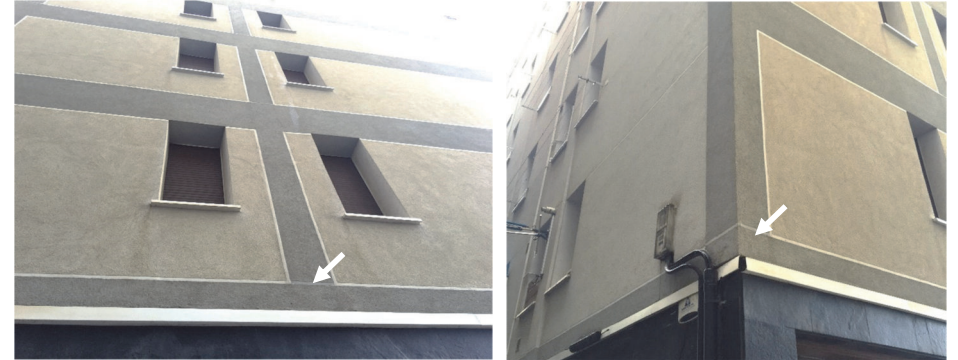
Imagen 59 e Imagen 60: SATE sin aparentes signos de patologías pero donde se aprecia la malla en algunos puntos, síntoma de posible error en la colocación de la malla y/o el espesor del mortero. Año 2015. Fuente: Marta Epelde.
