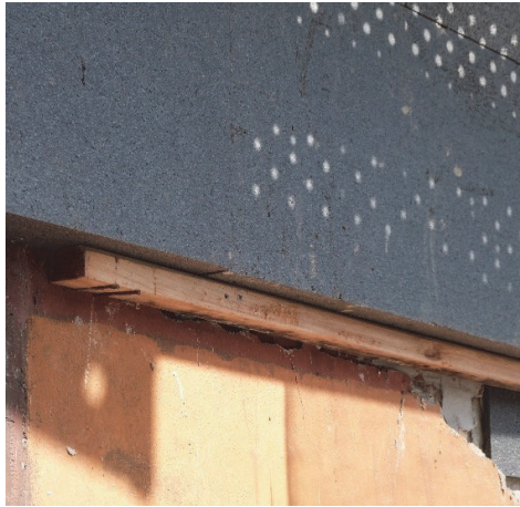
Imagen 33: El error en el planteamiento del perfil de arranque provoca una ejecución inadecuada que afecta a todo el perímetro de arranque del SATE.
