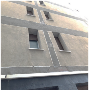
Imagen 10: Fachada existente con acabado desconchado. Fuente: Marta Epelde.
