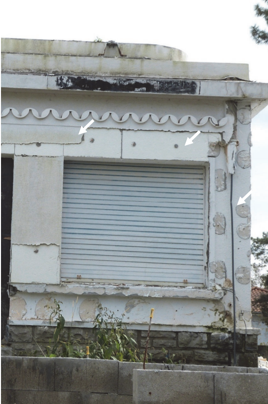
Imagen 57: SATE extremadamente deteriorado donde se observa la rotura de la malla, las escasas espigas y el desprendimiento del mortero y de las placas de aislamiento. Fuente: Marta Epelde.
