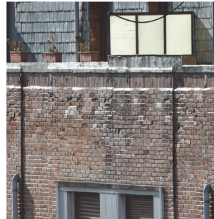
Imagen 12: Fachada de fábrica en estado pulverulento. Fuente: Marta Epelde.
