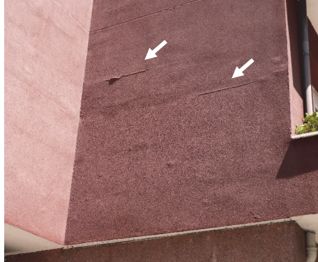
Imagen 39: Detalle de la fisuración en las juntas del SATE. Fuente: Marta Epelde.
