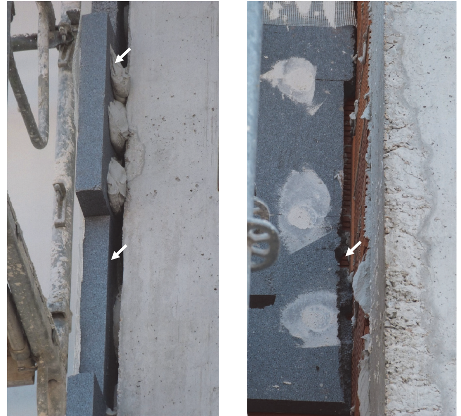
Imagen 55: Remate en esquina incorrecto: ausencia de encaje dentado y adhesivo sin cordón perimetral Fuente: Marta Epelde.
