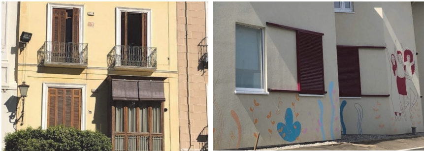
Imagen 17: Sombreamiento móvil vertical (contraventanas y persiana tipo alicantina) en fachada oeste (Murcia). Fuente: Marta Epelde.
