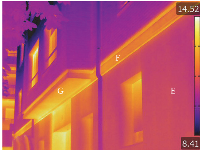
Imagen 2: Detalle de ausencia de continuidad de envolvente térmica provocando discontinuidad en la envolvente en el suelo del mirador (G), canto forjado (F) y planta baja (E). Fuente: Marta Epelde.
