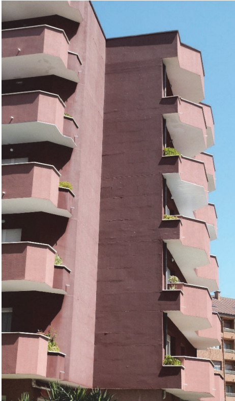
Imagen 38: Grietas y fisuras coincidente con las juntas de paneles aislantes. Fuente: Marta Epelde.
