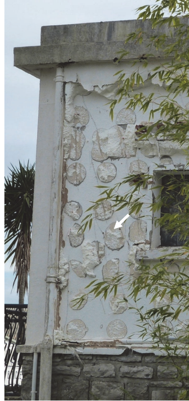
Imagen 58: Placas de aislamiento desprendidas (se observan las pelladas de adhesivo pero no existe cordón perimetral de adhesivo). Fuente: Marta Epelde.
