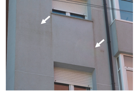
Imagen 42: Ensuciamiento en zonas de escorrentía del SATE. Fuente: Marta Epelde.
