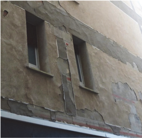
Imagen 32: El error generalizado en el planteamiento de la capa base provoca una patología que afecta a toda la superficie del sistema.
