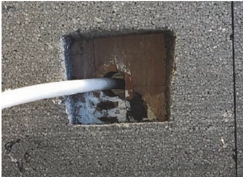
Imagen 6: Ejemplo de incorrecto aislamiento de un SATE ya instalado que ha sido recortado para el paso de una instalación no planificada. Fuente: Marta Epelde.
